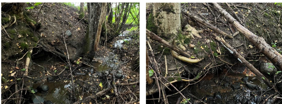
Figur 26. Bilder på erosionsskador uppkomna längs med bäckens västra sida nedströms (Rejlers 2024).
