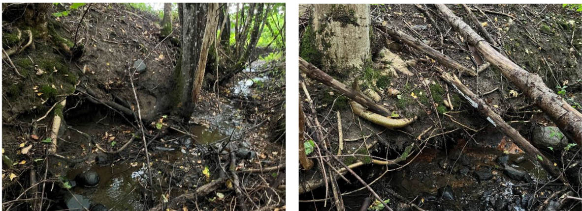
Figur 25. Bilder på erosionsskador uppkomna längs med bäckens västra sida nedströms (Rejlers 2024).
