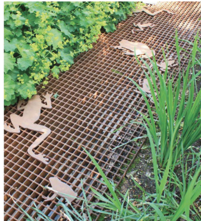
Dike med galler fungerar som tunnel för groddjur och tillgängligör. Källa: Stockholm stad.
