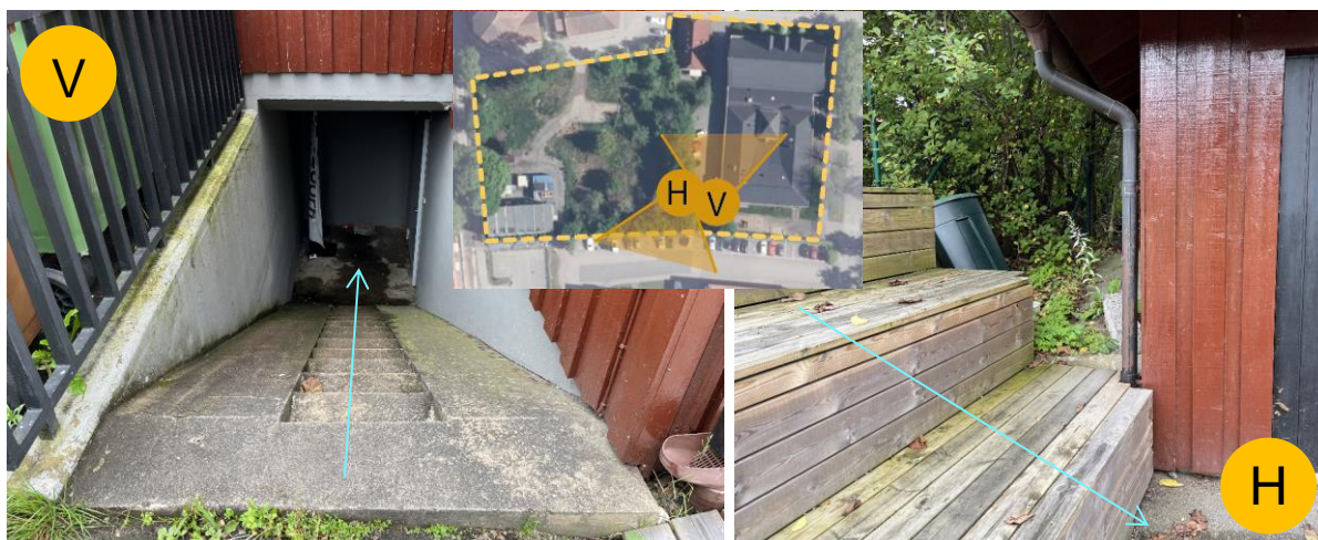
Figur 9: Vänster bild visar nedfart med trappa till källarplan till byggnad. Det mörka golvet visar att golvet är fuktigt. Höger bild visar sittrappa i slänt samt stuprör kopplat direkt ner i marken.
