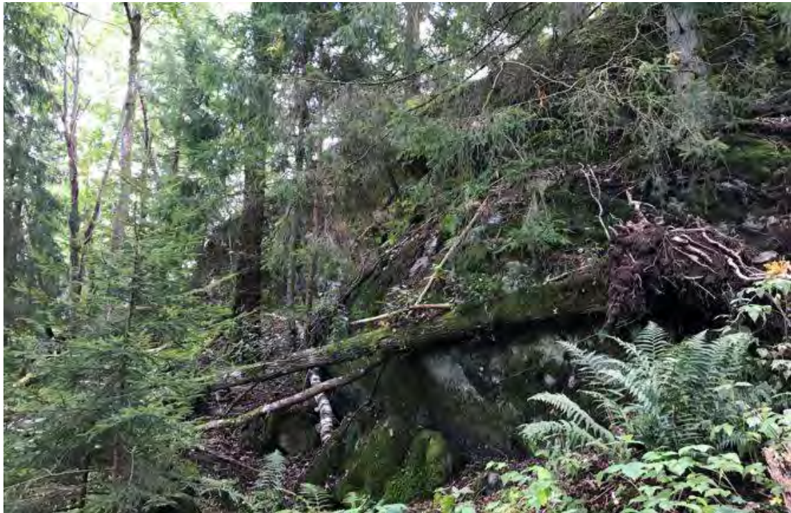
Figur 8. Släntens stupning tilltar i dess nedre delar där även tendenser till överhäng finns. Uppenbart lösa block som riskerar att rasa ned har inte observerats.
