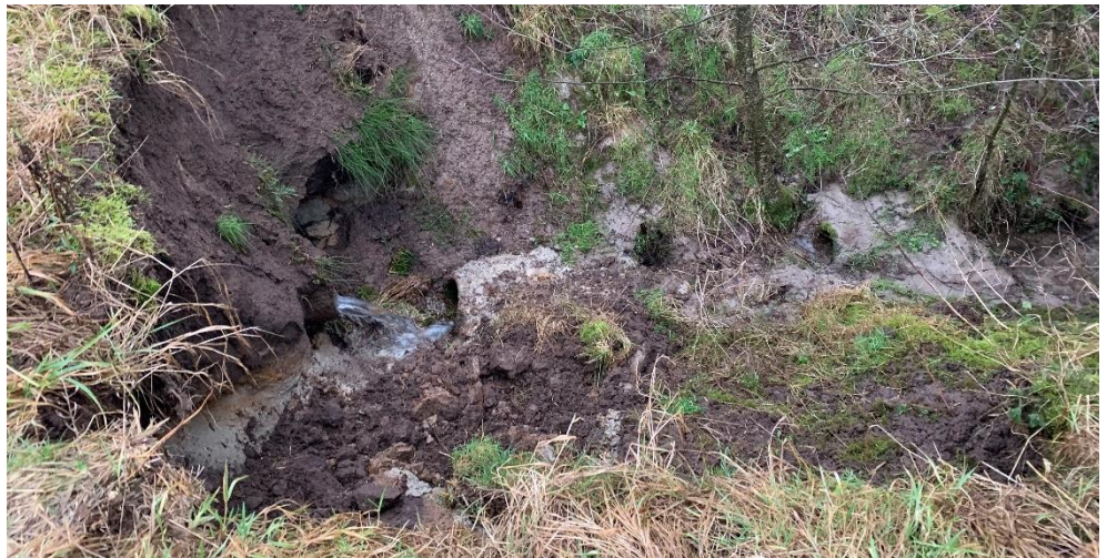
Figur 14, Samma skred ovanifrån, åkerdräneringen syns tydligt.
