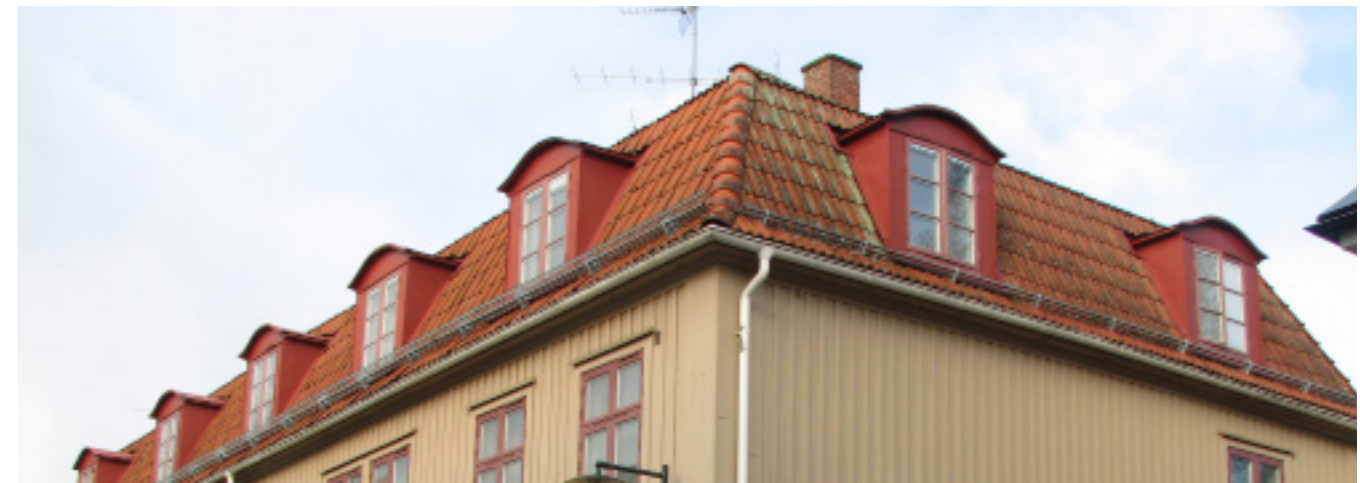
Smäckert och tidstypiskt utformade takkupor som harmonierar med takutformning och husets arkitektur.
